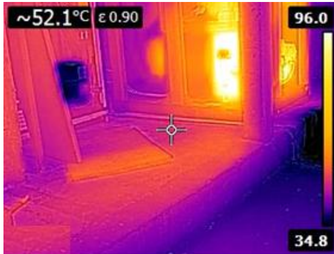
Figura 3 - Imagem de exame de termografia da sala de geração de ar comprimido
