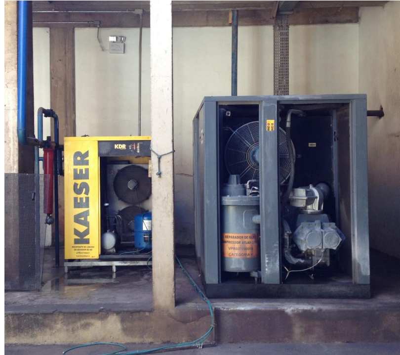
Figura 1 - Sala de geração de ar comprimido
