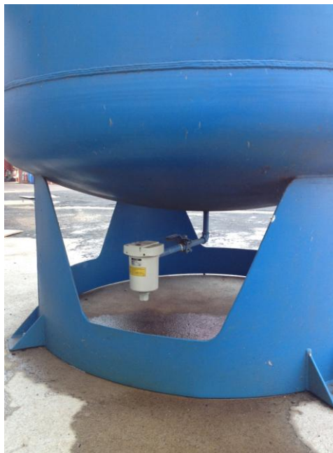
Figura 16 – Drenos instalados nos reservatórios de ar comprimido
